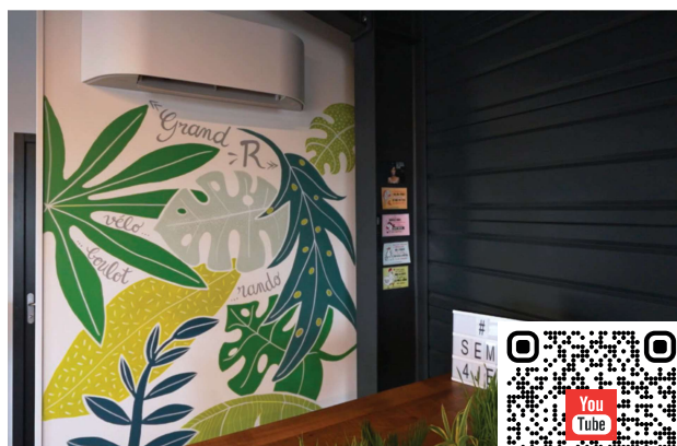
Colocworking S4J - Saint-Martin La Plaine / Installateur Le Froid Forézien - Crédit Photo Blue Production
